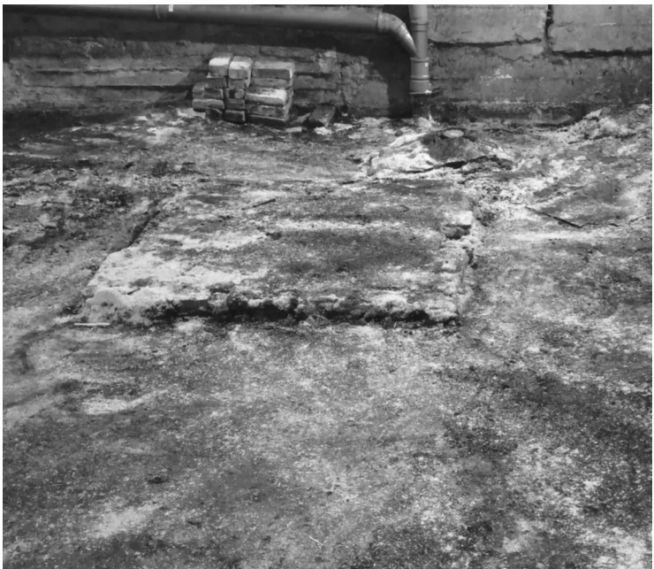
❖ Подтопление убрано и засыпано опилками
